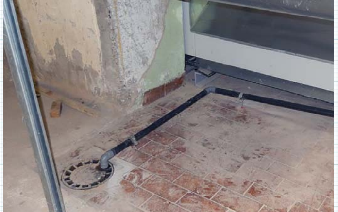
En l'absence de réseau d'évacuation des eaux usées proche, l'évacuation des condensats est raccordée sur le réseau d'évacuation des eaux pluviales. ©AOC
