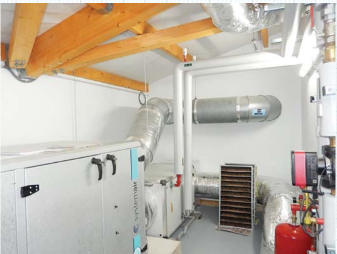
L'accès à la CTA est aisé, l'intervention est donc possible sur l'ensemble des équipements du système. ©AQC
