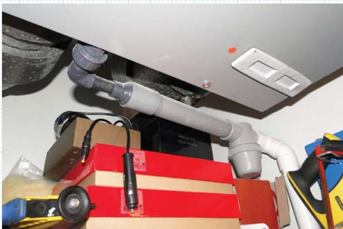
L'évacuation des condensats a été raccordée au réseau d'eaux usées du bâtiment. ©AOC
