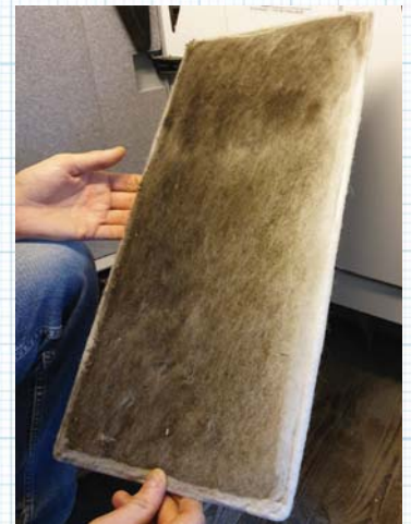
Le filtre présente un encrassement important car il n'a pas été changé dans le délai imparté. ©AQC
