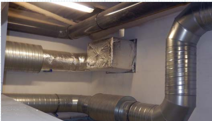
Dans cette installation, l'ouverture du caisson est orientée vers l'extérieur. Le changement du préfiltre est réalisable uniquement par une nacelle depuis l'extérieur. Ce surcoût peut décourager la MOA. ©AQC
