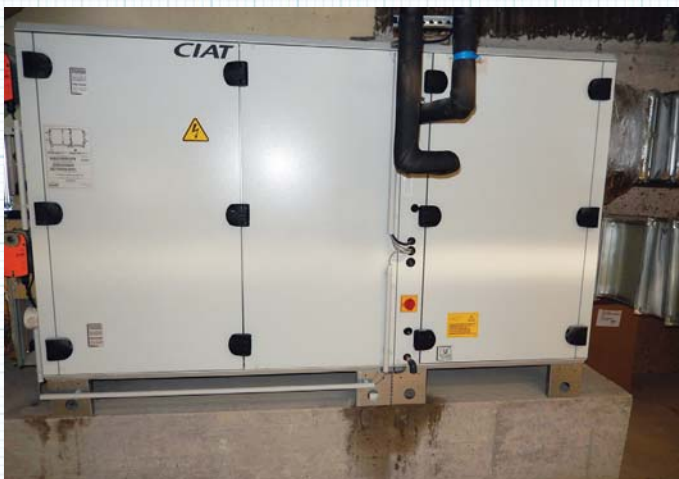
Sur cette CTA, l'évacuation des condensats n'a pas été raccordée au réseau EU ou EP, ce qui engendre de l'humidité sous la CTA. ©AOC
