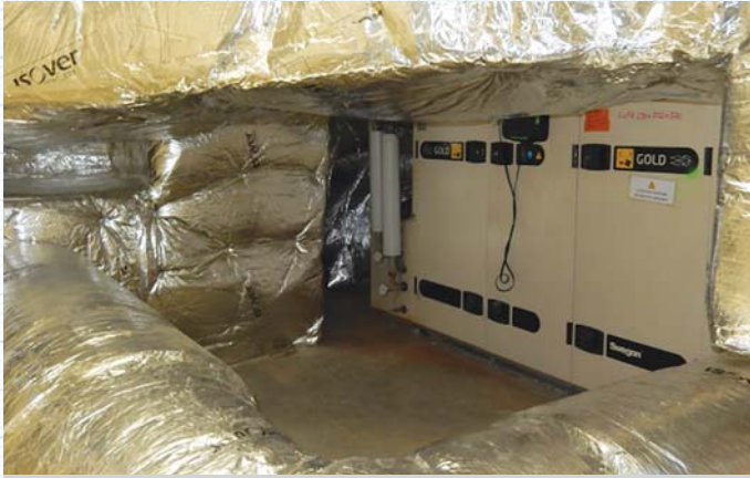
Le cheminement et l'encombrement du réseau aéraulique empêchent un accès aisé à la CTA. ©AQC
